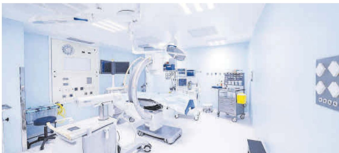
El nuevo bloque quirúrgico hospitalario permite intervenir todo tipo de patologías en condiciones óptimas para el paciente.
